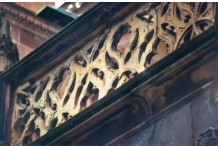
Écaillage, désagrégation sableuse de la balustrade du Transept Nord
