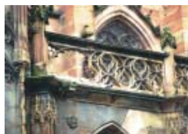
Fracturation de la balustrade du Transept Nord
