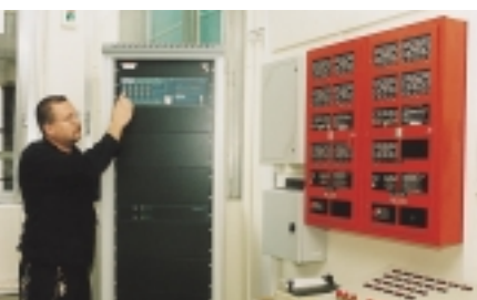
Armoire de commande des portes coupe-feu en Faculté de médecine
